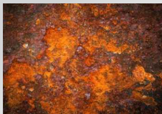
Corrosão localizada em tubulação de condução de fluido
